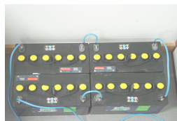
Figura 16 – Banco de baterias
